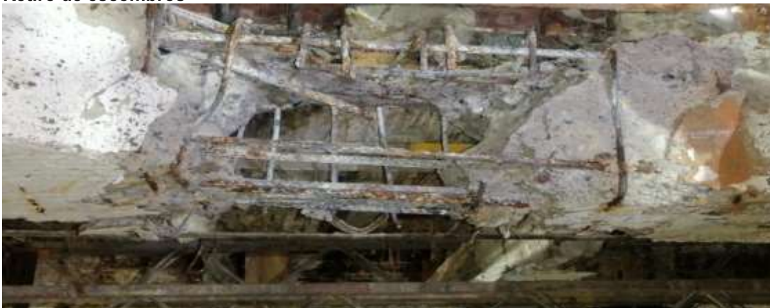
Flejes que fueron instalados en forma incompleta durante la construcción inicial.
