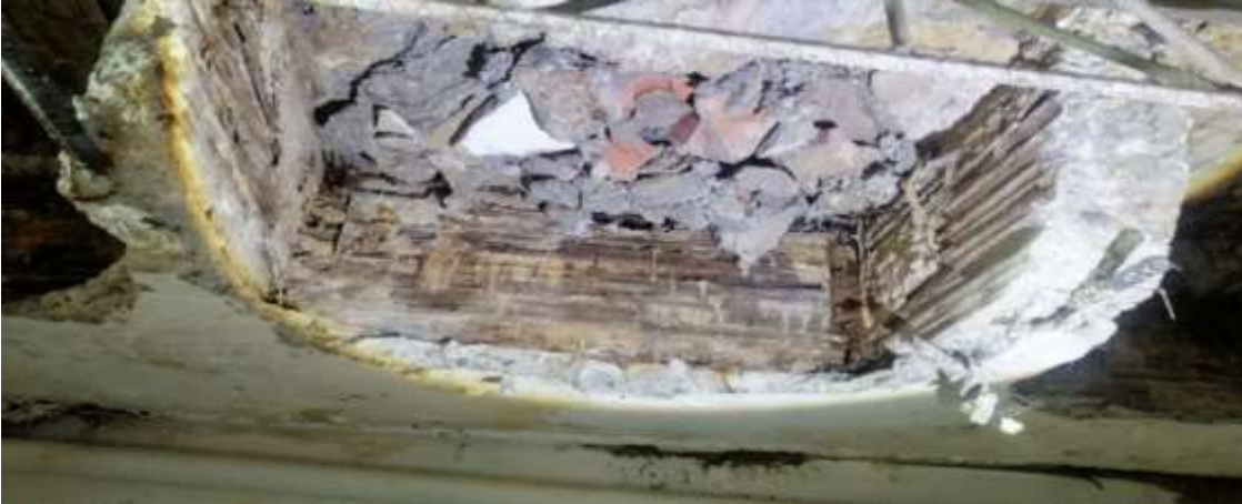
Detalle de fundida placa existente
