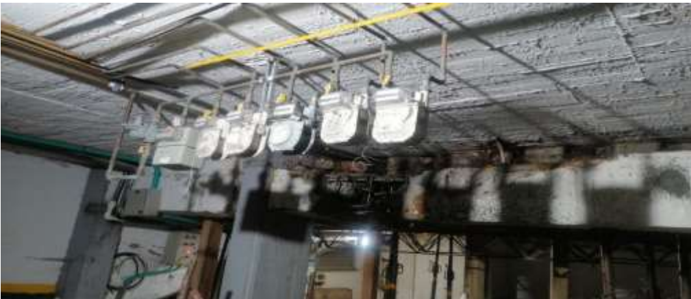
Estado final provisional contadores de gas.
