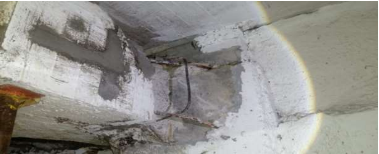
Nodo de conexión deficiente a resistencia de corte y momento flector
